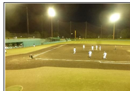
夜間照明設備
